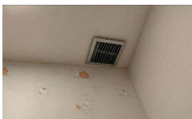
Gambar 13. Exhaust fan pada ruang laktasi Plaza Malioboro Sumber: Dokumentasi Survei (2025)
