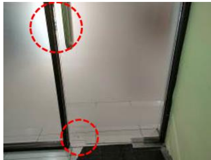
Gambar 11. Celah pada Pintu Ruang Laktasi Galleria Mall Sumber: Dokumentasi Survei (2025)
