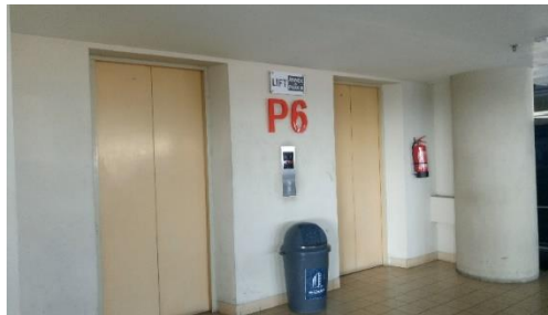
Gambar 10 : Lift pada Annex Building Lt. P6
