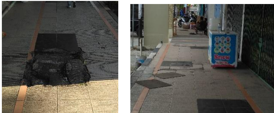
Gambar 2. Keramik yang pecah Jalur pedestrian di jalan A. Yani, Peunayong Sumber: Dokumentasi Pribadi (2025)
