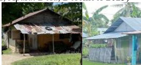
Gambar 6. Kondisi Rumah Tidak Layak Huni
