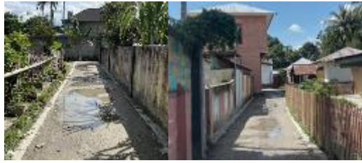
Gambar 3. Kondisi Kerusakan Jalan Lingkungan
