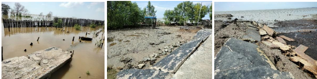
Gambar 8. Jalan dan Dermaga yang Rusak Akibat Gelombang Laut
