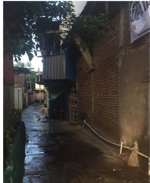
Gambar. 3 Kondisi drainase lingkungan Sumber : Hasil survey lapangan, Juni 2020
